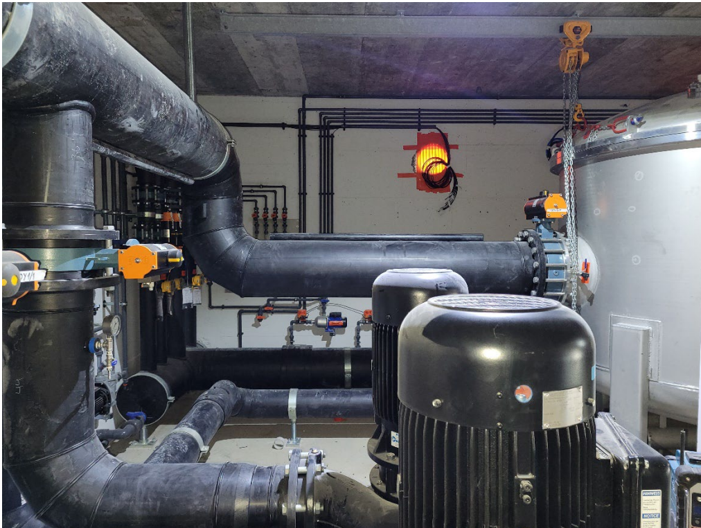
Einblick in die neue Technikzentrale
